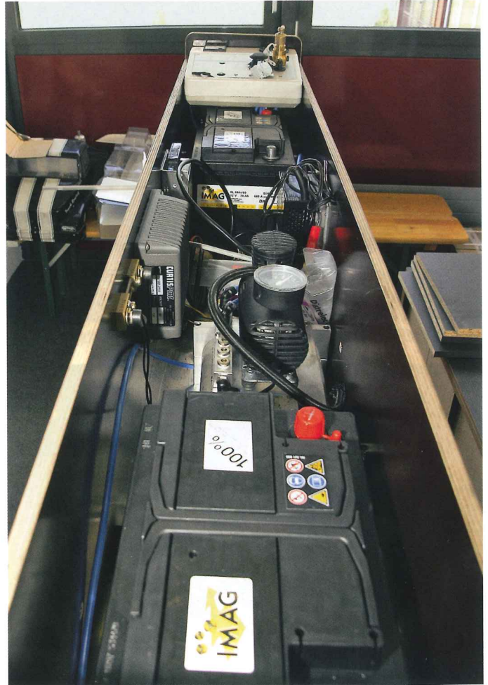
Blick in den geöffneten Batteriewagen mit Kompressor für die Zugbremse.
